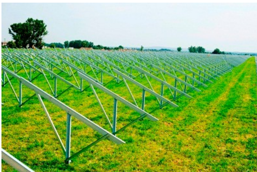
Konstrukcja – stoły pod panele fotowoltaiczne
