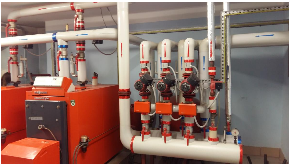
Istniejąca instalacja w kotłowni
