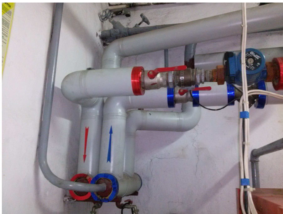
Istniejący rozdzielacz przeznaczony do wymiany – miejsce wpięcia nowej instalacji
