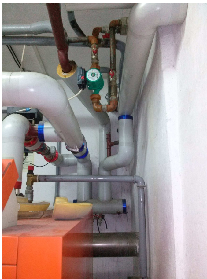
Istniejąca instalacja w kotłowni
