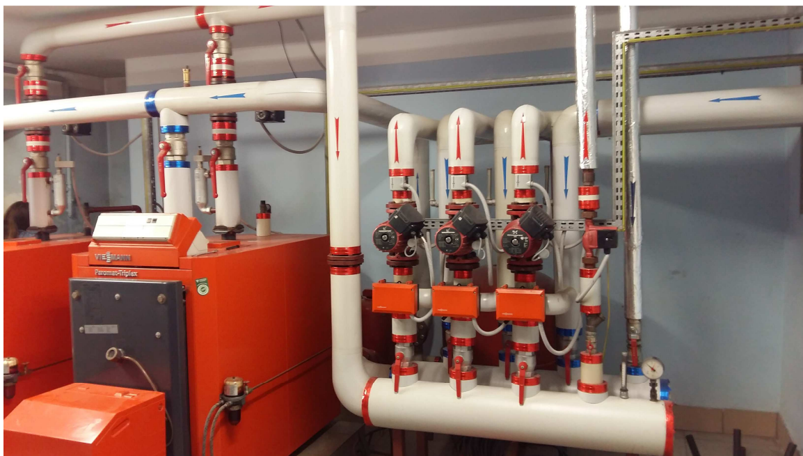
Istniejąca instalacja w kotłowni
