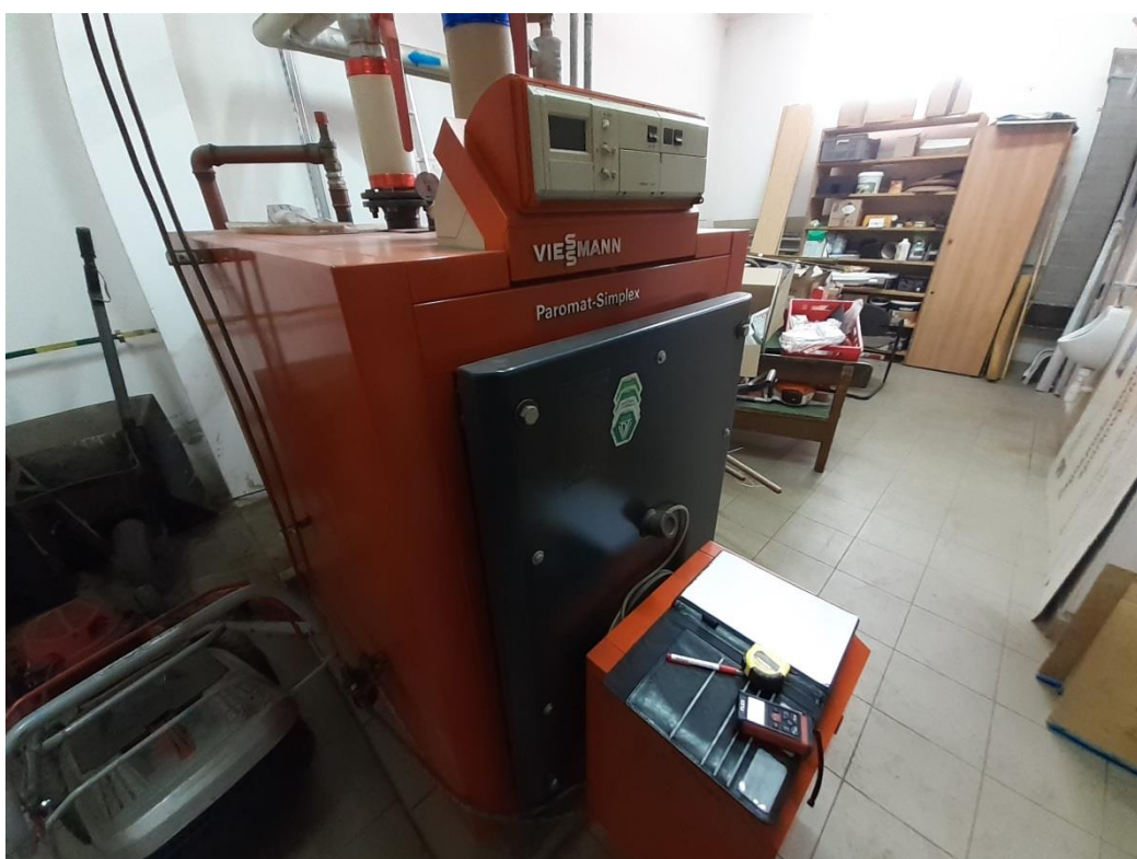
Istniejący kocioł na olej opałowy 225 kW
