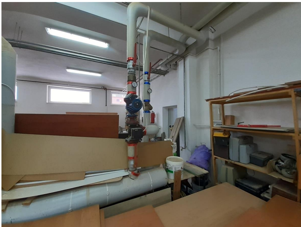
Istniejący rozdzielacz w pomieszczeniu gospodarczym
