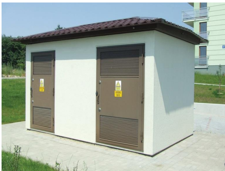
Fot. 7 Przykładowa kontenerowa stacja transformatorowa
