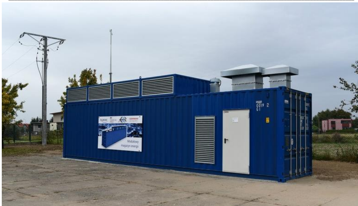
Fot. 8 Modułowy (kontenerowy) magazyn energii, który będzie zastosowany w planowanej elektrowni.
