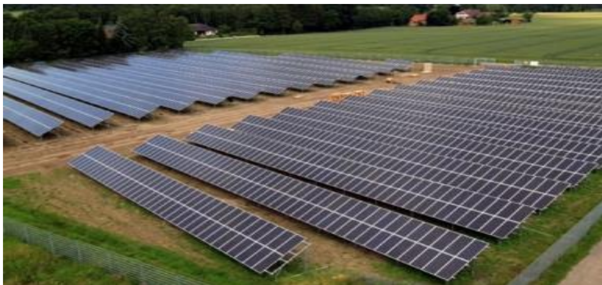
Fot. 1 Rzędowe posadowienie paneli
