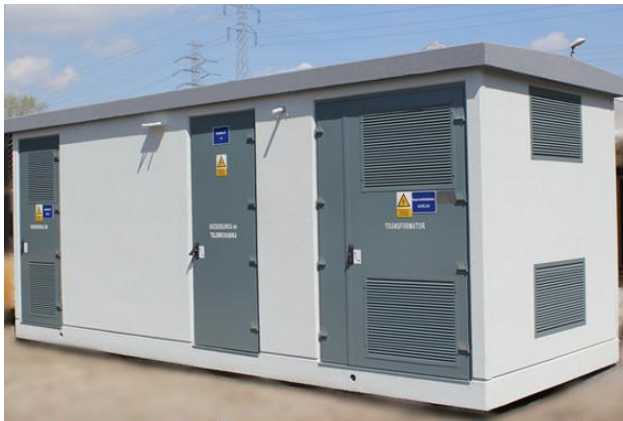
Rys. 3.3. Przykładowa stacja transformatorowa
