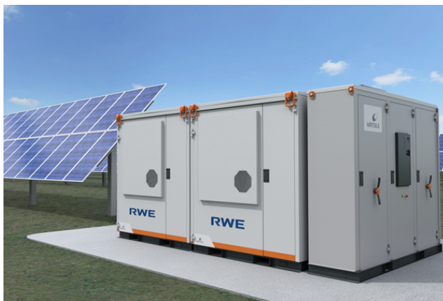
Rys. 3.4. Przykładowy magazyn energii
