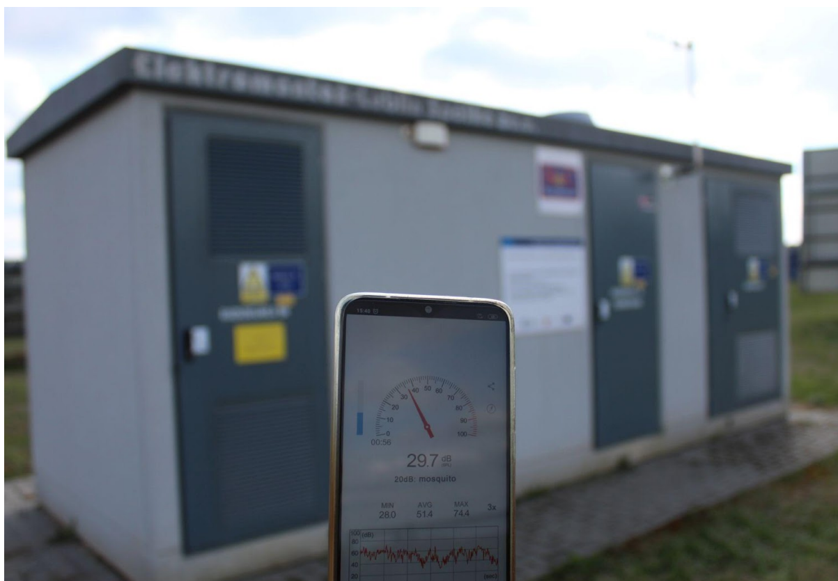
Zdj. Poziom dźwięku emitowany przez stację transformatorową
