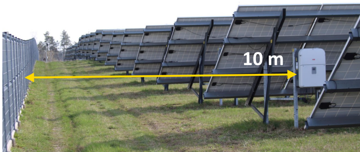
Zdj. Typowa farma PV i zamontowany inwerter - zachowany odstęp techniczny od ogrodzenia.
