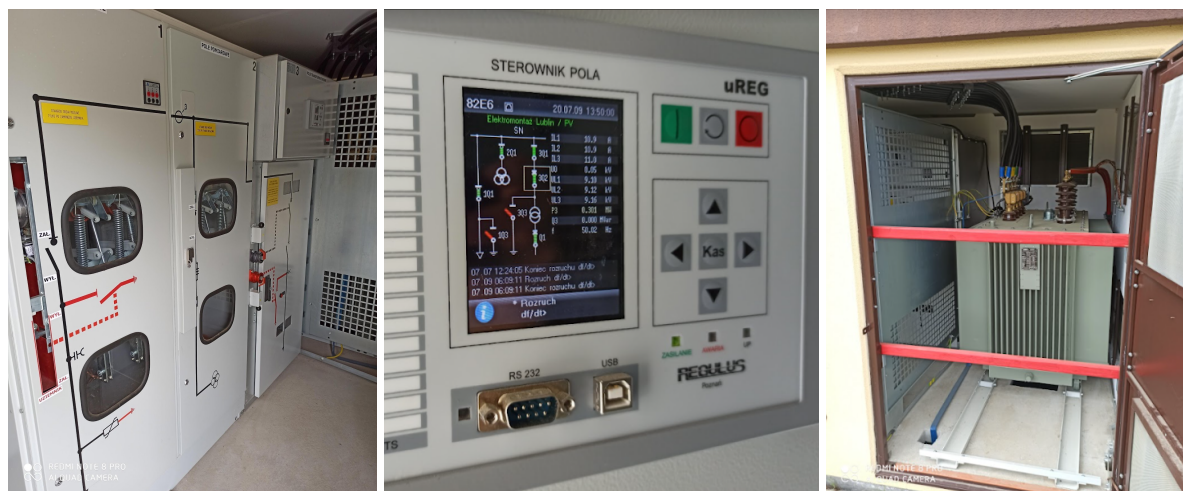
Zdj. Wnętrze stacji transformatorowej i transformator olejowy
