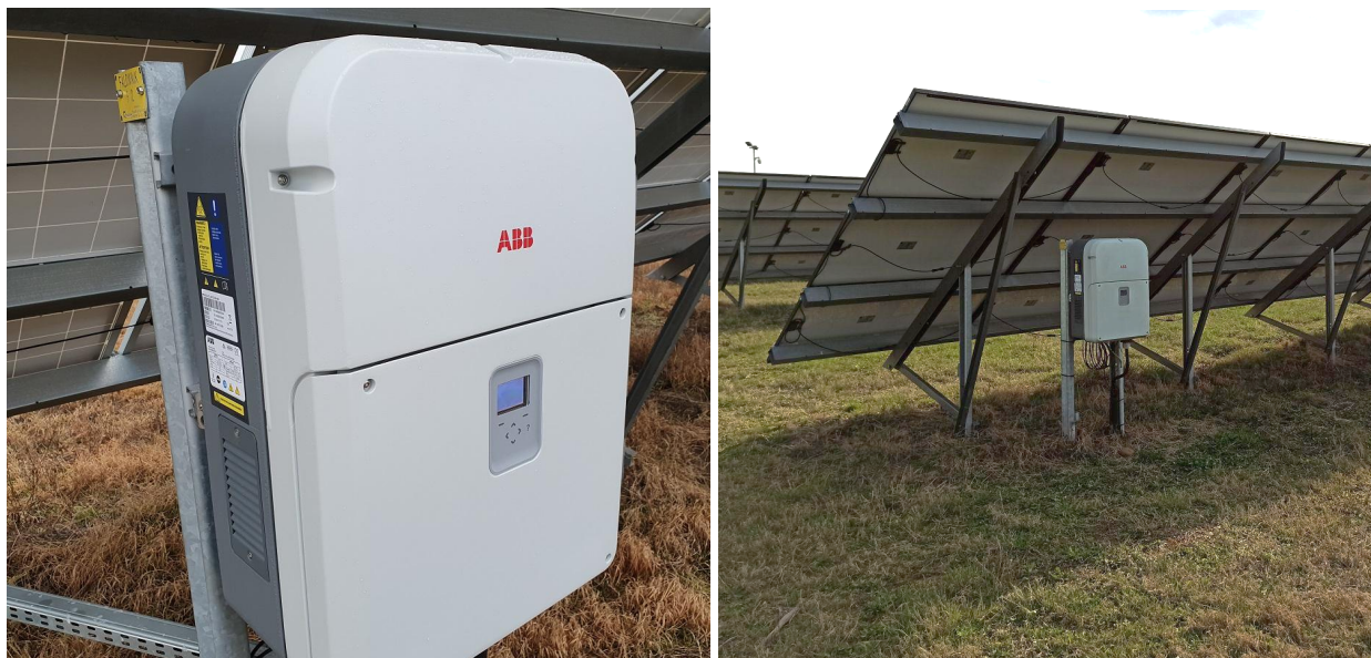
Zdj. 2 Inwerter na farmie fotowoltaicznej
