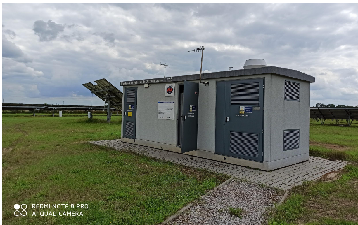
Zdj. 14 Kontenerowa stacja transformatorowa na farmie PV
