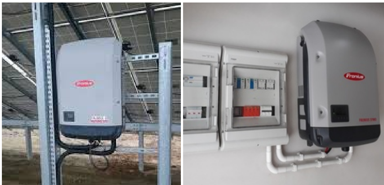
Zdj. 18 Inwerter firmy Fronius na farmie PV oraz w prywatnym domu
