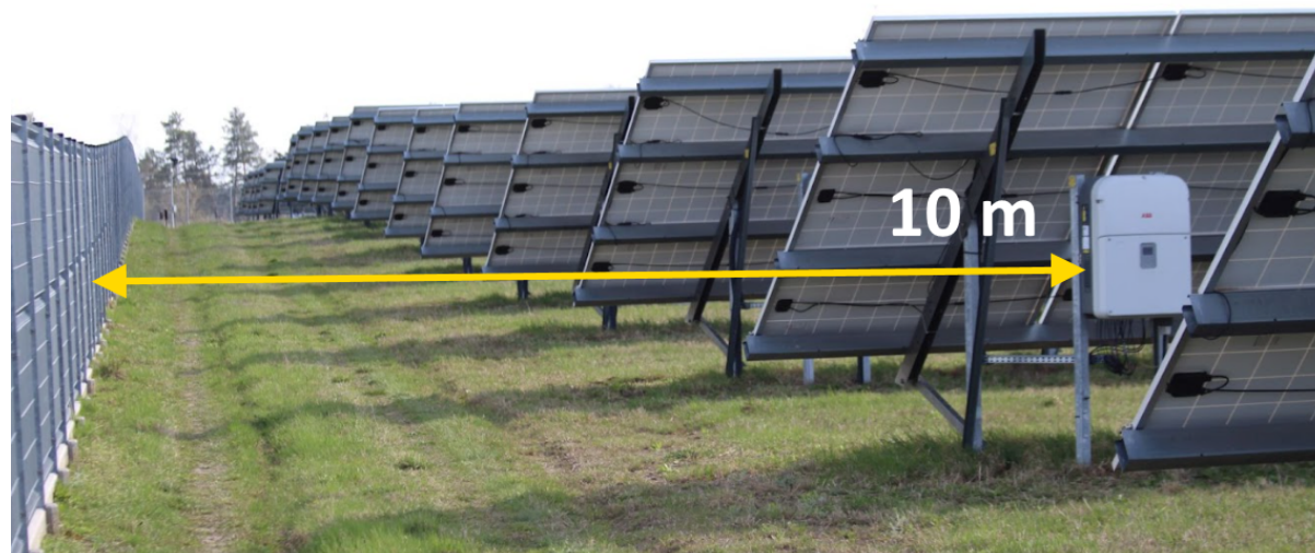
Zdj. 19 Typowa farma PV i zamontowany inwerter - zachowany odstęp techniczny od ogrodzenia.
