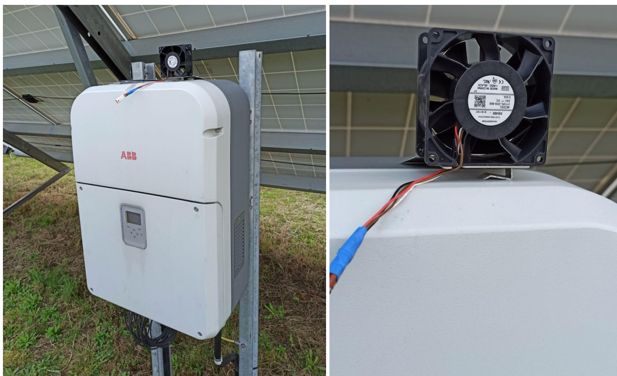
Zdj. 16 Wentylator inwertera
