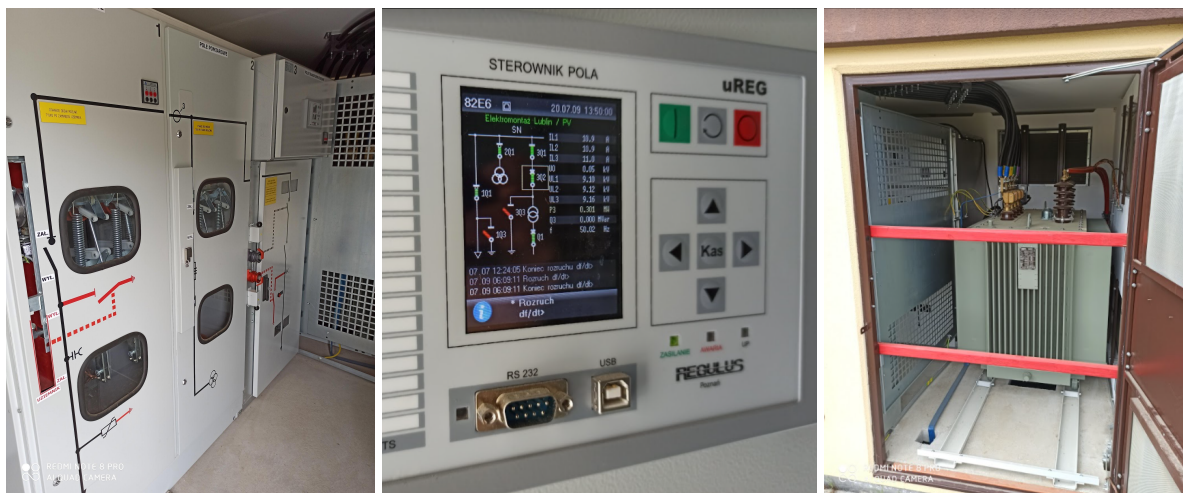
Zdj. 4 Wnętrze stacji transformatorowej i transformator olejowy
