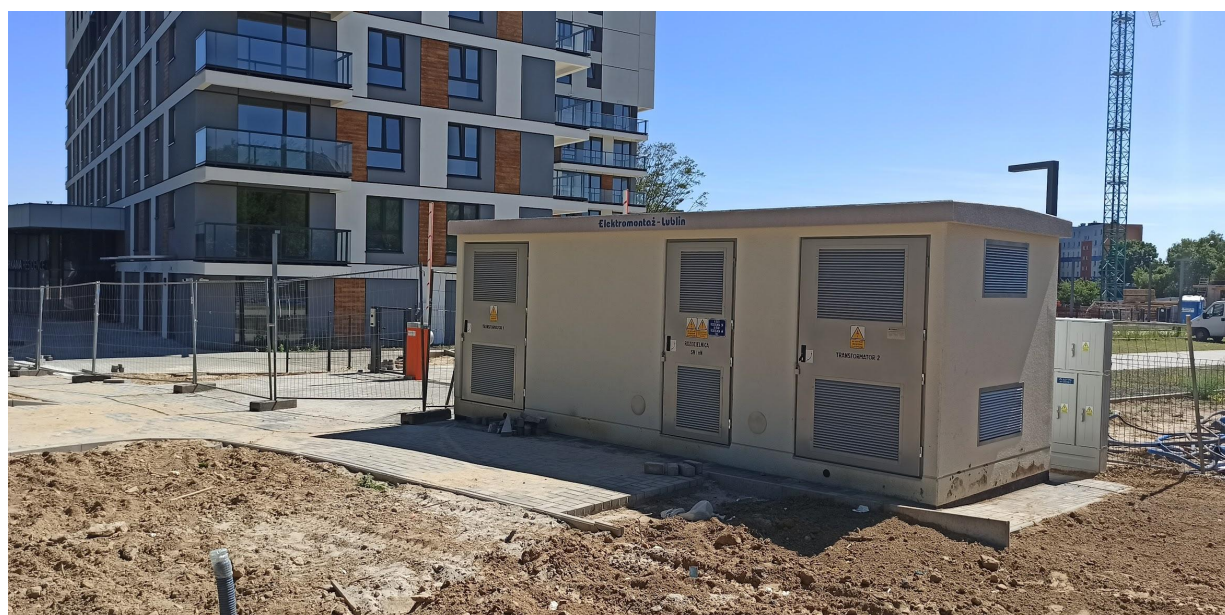
Zdj. 15 Kontenerowa stacja transformatorowa na nowo budowanym osiedlu mieszkaniowym
