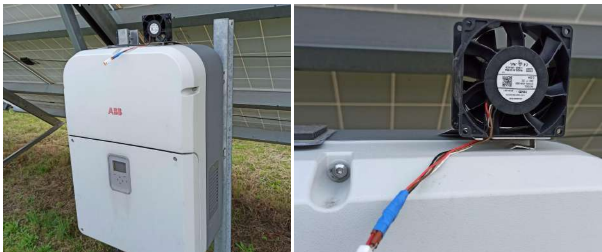
Zdj. Wentylator inwertera (analogiczne jak te stosowane w typowych zasilaczach komputerowych)
