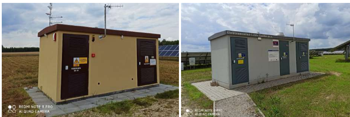
Zdj. Funkcjonujące kontenerowe stacje transformatorowe
