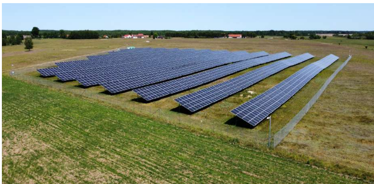
Zdj. Typowa farma PV - widoczne na narożnikach kamery na podczerwień (brak stałego oświetlenia)
