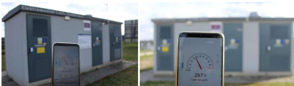
Zdj. Poziom dźwięku emitowany przez stację transformatorową
