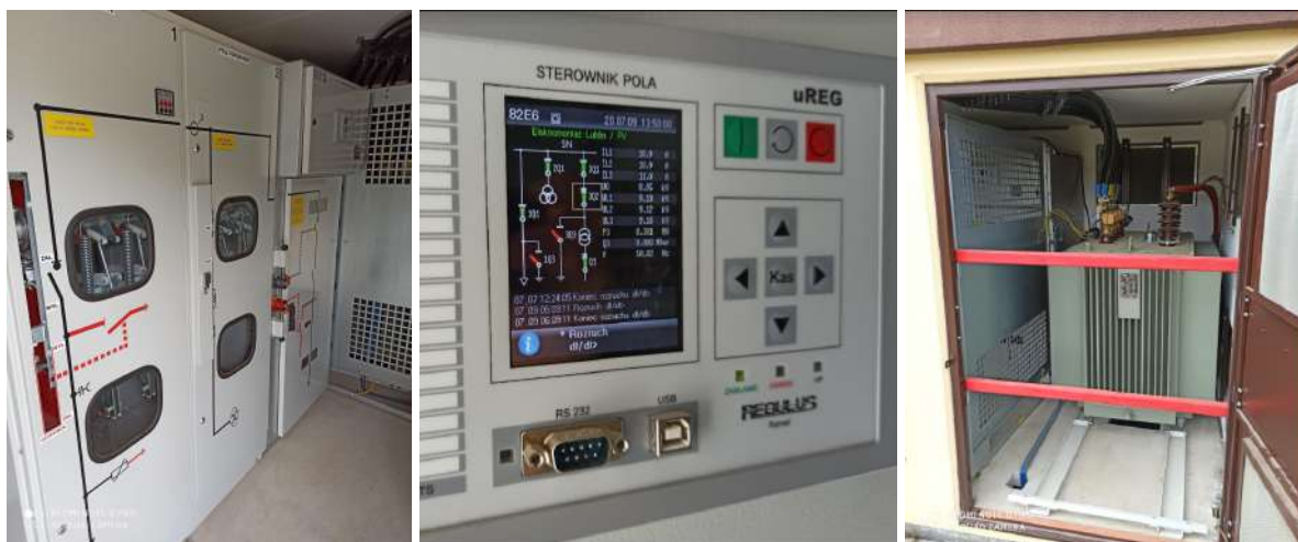
Zdj. Wnętrze stacji transformatorowej i transformator olejowy
