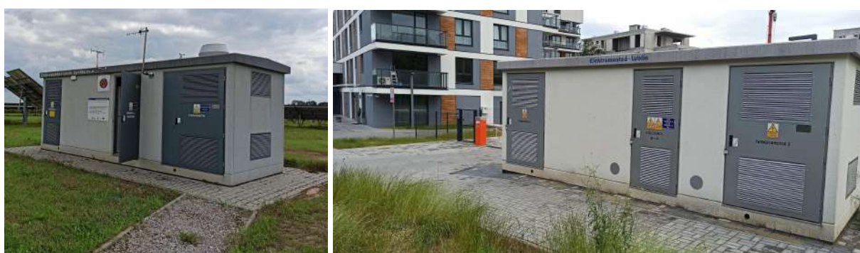
Zdj. Funkcjonujące kontenerowe stacje transformatorowe - na farmie PV i nowym osiedlu w Lublinie
