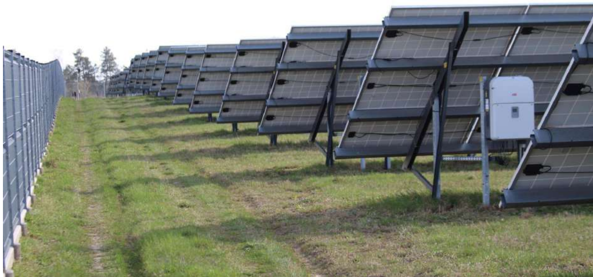
Zdj. Inwerter zamontowany na farmie PV
