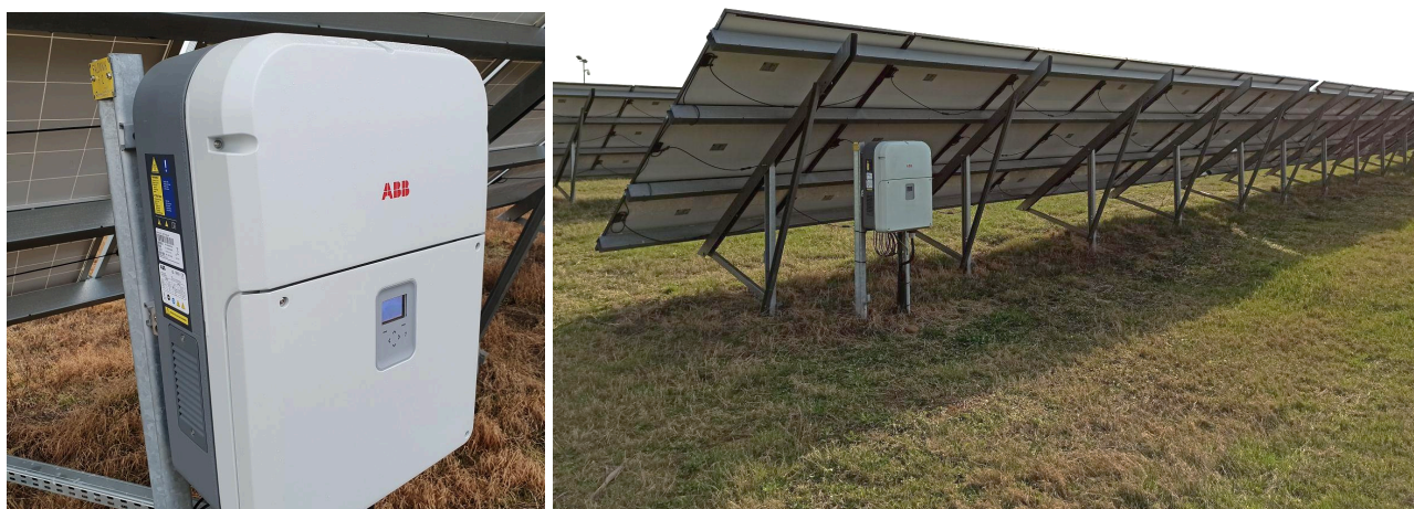
Zdj. 4 Inwerter na farmie fotowoltaicznej
