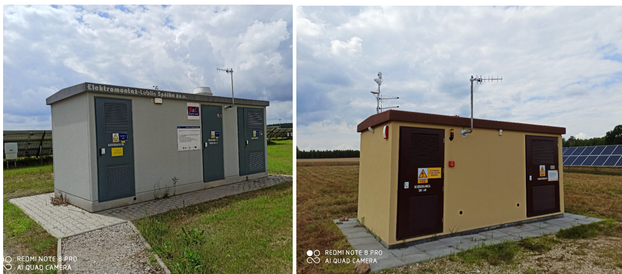
Zdj. 5 Funkcjonujące kontenerowe stacje transformatorowe
