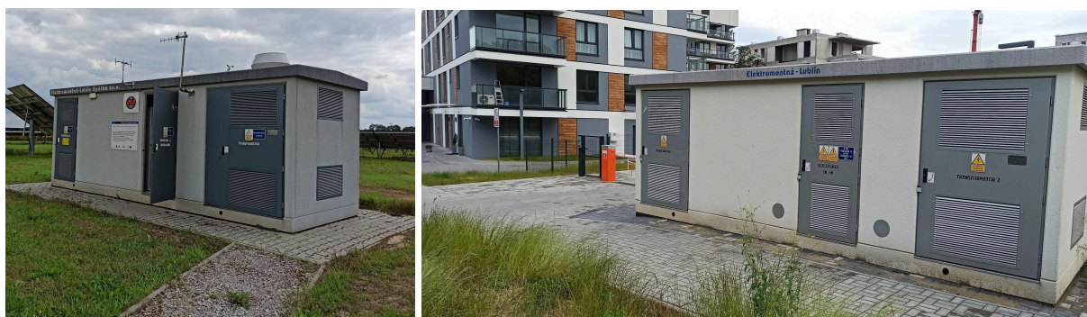
Zdj. 16 Funkcjonujące kontenerowe stacje transformatorowe - na farmie PV i nowym osiedlu w Lublinie
