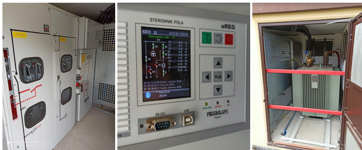
Zdj. 6 Wnętrze stacji transformatorowej i transformator olejowy
